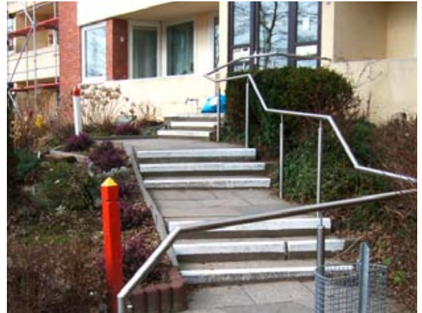
Vorher: Stufen zum Hauseingang mit Stufenkantenunterschneidungen.
