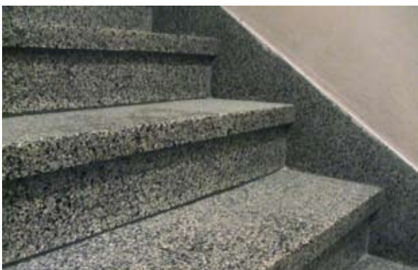
Stufenkantenunterschneidungen sind gefährliche Stolperfallen.
